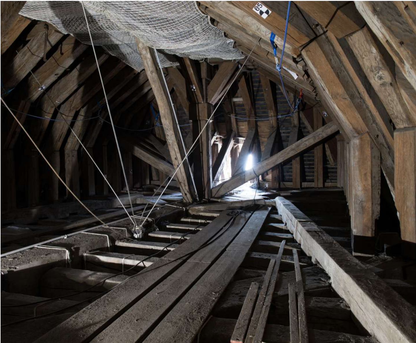
La charpente de la Chapelle royale avant restauration © château de Versailles, Thomas Garnier
