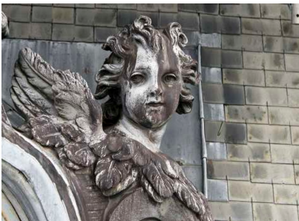
Décor en plomb de l'œil-de-bœuf avant restauration © château de Versailles, Thomas Garnier
