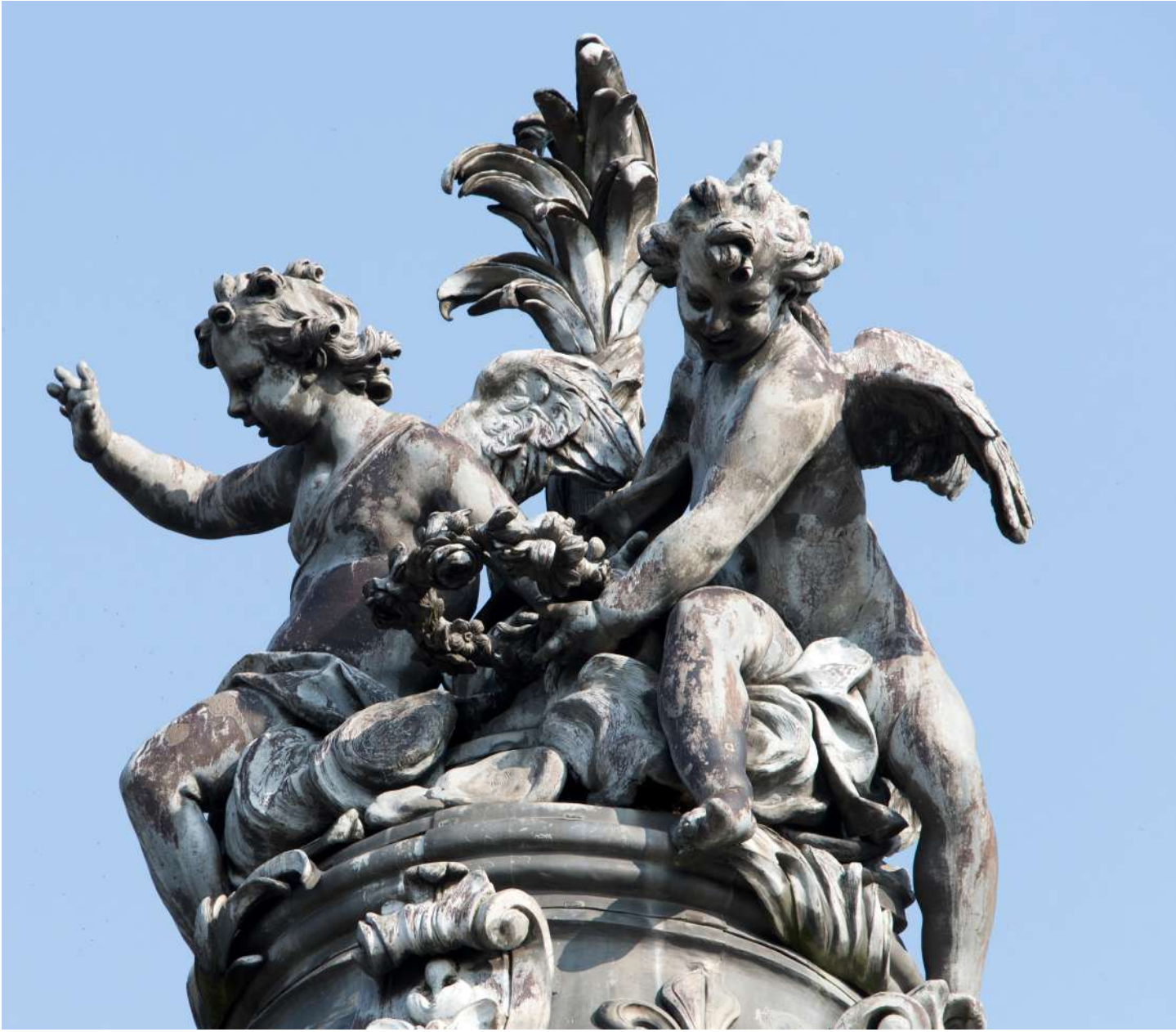
Modénature en plomb de la partie haute de la toiture (côté ouest) avant restauration © château de Versailles, Thomas Garnier
