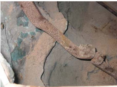
Dégradation des ossatures intérieures de la statue équestre © Cabinet Didier
