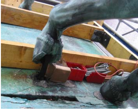
Corrosion des fers extérieurs soutenant la statue équestre © Cabinet Didier
