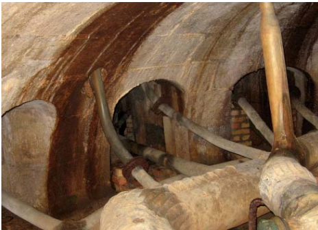
Machinerie souterraine du bassin de Latone © château de Versailles, C. Milet
